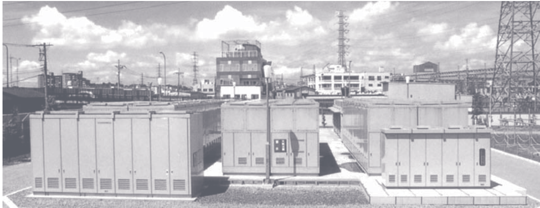
NATRIUM-SCHWEFEL-HOCHTEMPERATURBATTERIE FÜR DEN SOGENANTEN LOAD-LEVELLING-BETRIEB
